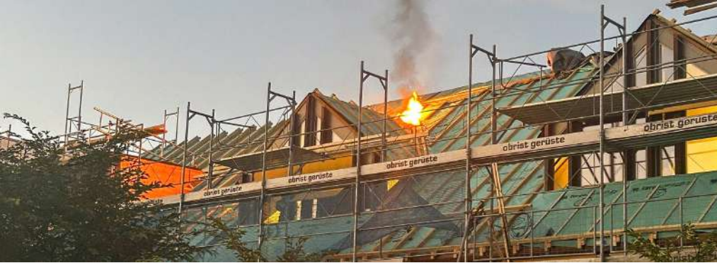
Brandausbruch während der Dachsanierung, Bild: Aargauer Zeitung
