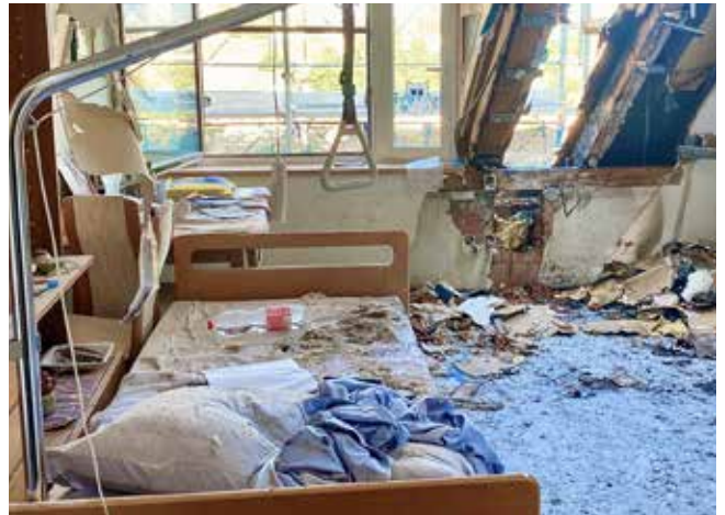
Der Ort des Brandausbruchs im Wand-/Dachbereich mit dem Schaden im vom Feuer betroffenen Wohnzimmer.
